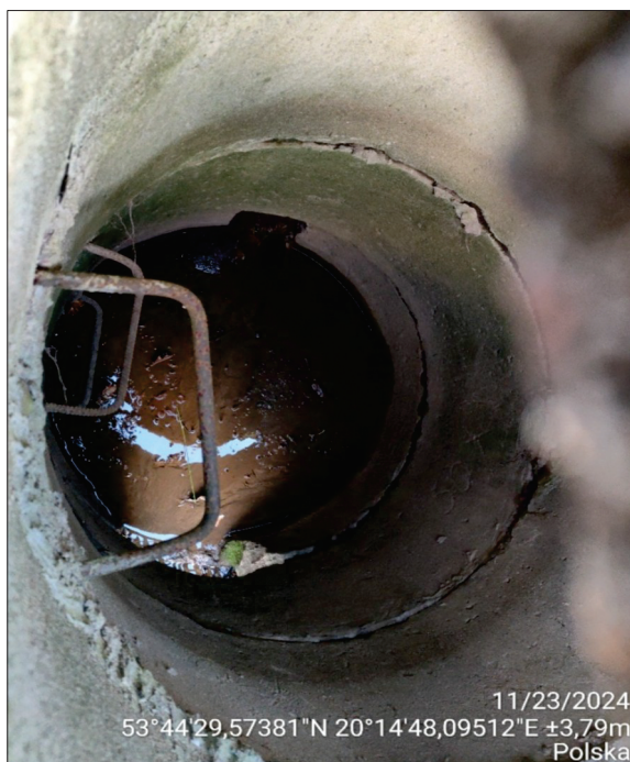
zdj. 9 dno studzienki z włączeniem sączka drenażowego
