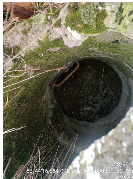
zdj. 21 dno studzienki zasypane urobkiem
