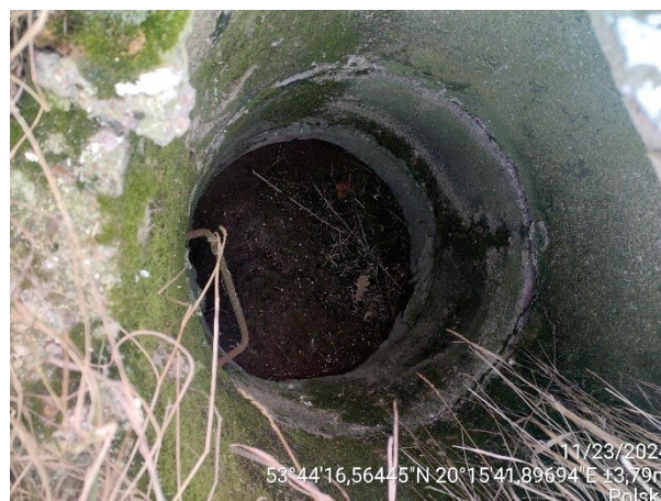
zdj. 23 dno studzienki zasypane urobkiem
